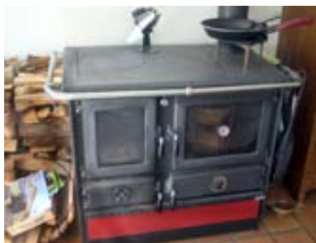
Den vedeldade kökspannan strålar ut värme lokalt, men laddar också en ackumulatortank i badrummet.
