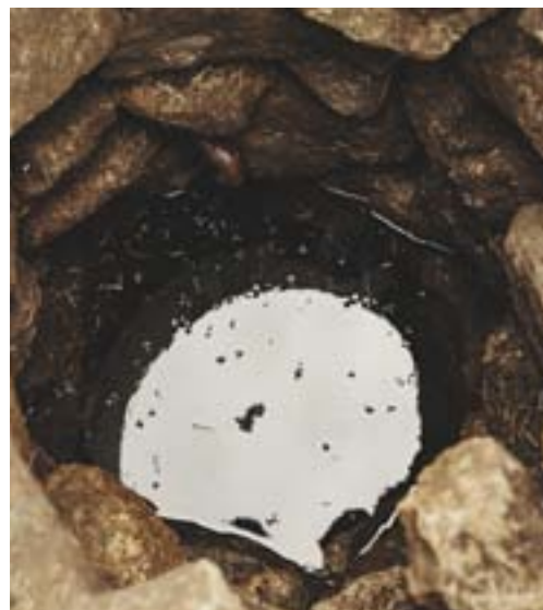
Grävd brunn som riskerar att sina.
