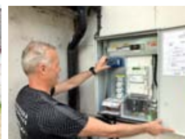
Elskåpet har kompletterats med ny mätarutrustning för sole och energilager.
