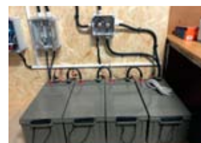
Batterierna på vinden säkrar elbehovet vid framtida strömavbrott.
