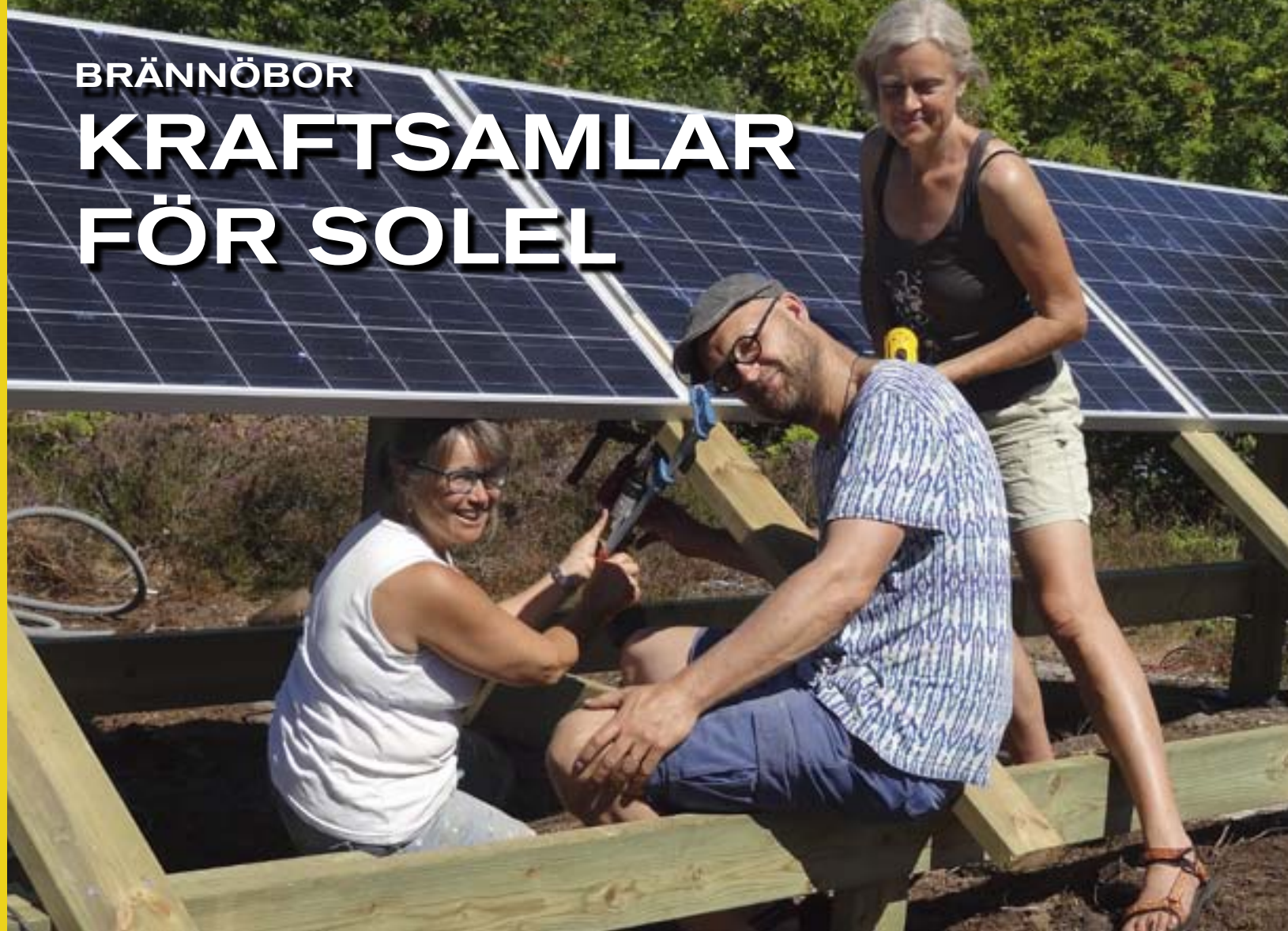
Samarbete på Brännö. Eva Grenfeldt, Jörgen Larsson och Astrid Abrahamsson hjälps åt att installera solcellspaneler.
