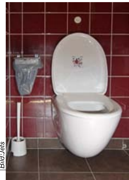
Vakuumtoaletter för enskilda hushåll finns både som golvstående och vägghängda. Exempel på varumärken i Sverige är: EkoVac, Jets, Fann – Toalettsystem, Roslagen.
