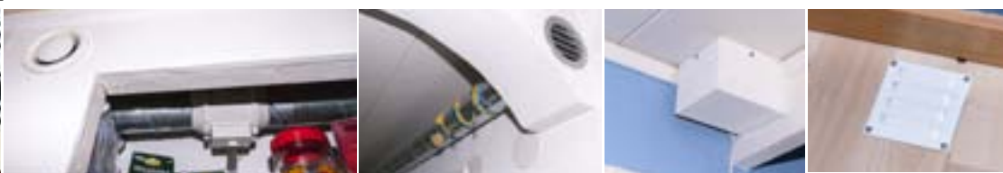
Installationer för att spara energi: Värmen cirkulerar runt via kanaler och fläktar, så att den når alla utrymmen i huset.
