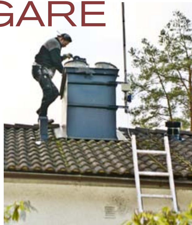
Säker skorsten? En äldre tegelskorsten kan behöva tätas invändigt med nytt keramikbruk.
