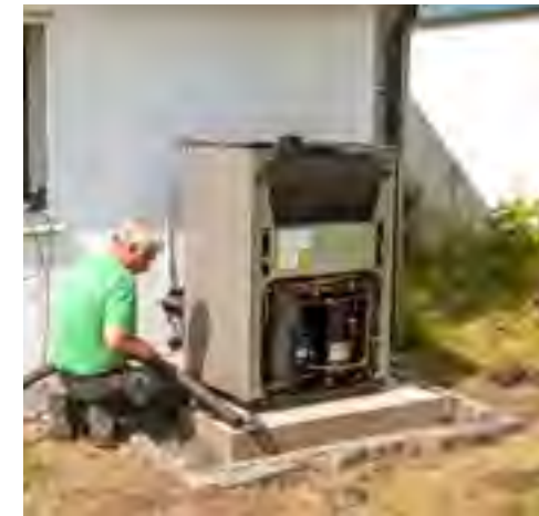
Värmepumpens styrsystem räkna ut hur förbrukningen kan optimeras under ett dygn.
