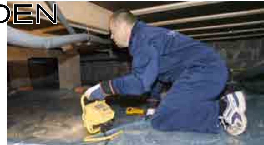
Genom att installera en krypgrundsavfuktare kan den relativa fuktigheten hållas nere, vilket minskar risk för mögeltillväxt.
