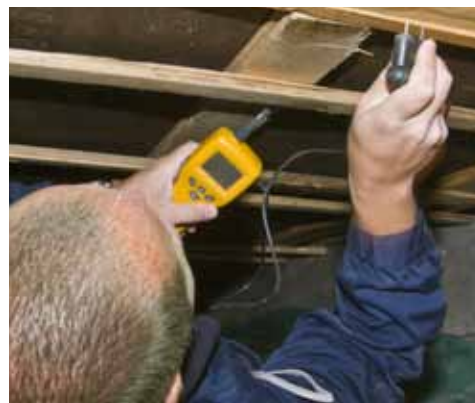
Misstänker du att du har fuktproblem - börja med undersöka huset, gärna med hjälp av en fuktmätare (hygrometer).
