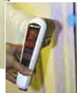
Blått ljus vid en skadad list, där är det ett läckage.
