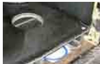
Att byta den gamla golvbrunnen borde, med facit i hand, var prio nummer ett vid en badrumsrenovering.
