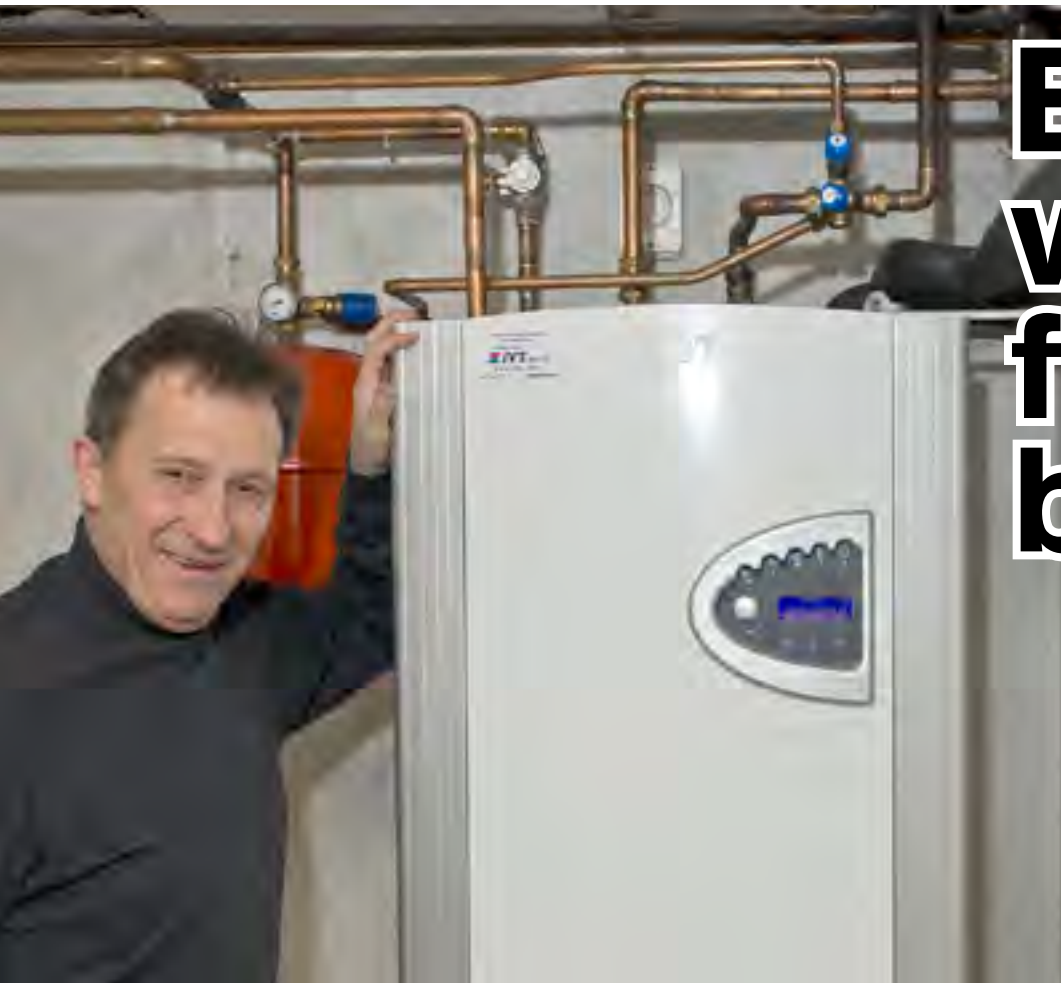
Henry Sjöström har sedan installationen av bergvärmepumpen följt energiförbrukningen i villan och jämfört med den ursprungliga kalkylen från värmepumpsleverantören.
