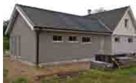
Fasader med en väggkonstruktion med puts på bakomliggande trävägg är ett problem runt om i Sverige.
