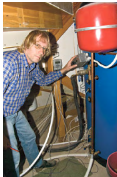
Akkumulatortanken på 750 liter lagrar sol- energi och kan förse huset med värme vid effektbrist.
