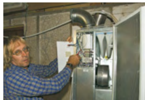
Värme och friskluft. Ventilationsvärmeväx- laren återvinner 85 procent av värmen i huset och förser huset med ny frisk luft
