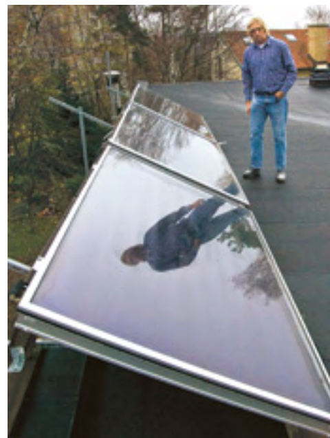
Läge för sol. 7,5 kvm solfångare förser huset med varmvatten under sommarhalvåret.
