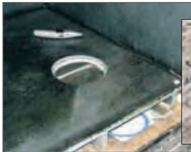
Felaktigt byggt och placerat avlopp.
