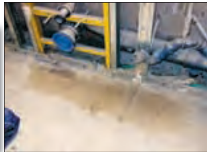
Fukt som gått ner i betongen.
