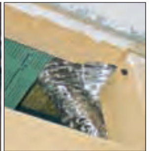
Deformerad ventilationskanal gjorde att ventilationen fungerade dåligt.
