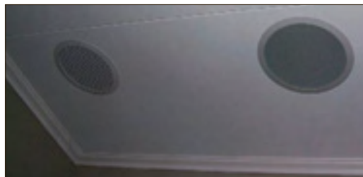
Högtalare är noggrant utplacerade i taket.
