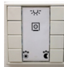
Strömbrytare för hela husets belysning.
